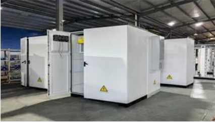
Sol-Up Solar , Premier Las Vegas Solar Provider
